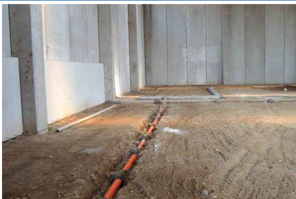
Figura 0.2 Dettaglio griglia pressa + canalizzazione alla vasca stagna
