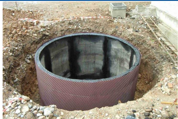
Figura 6.3 Dettaglio vasca stagna raccolta percolato pressa
