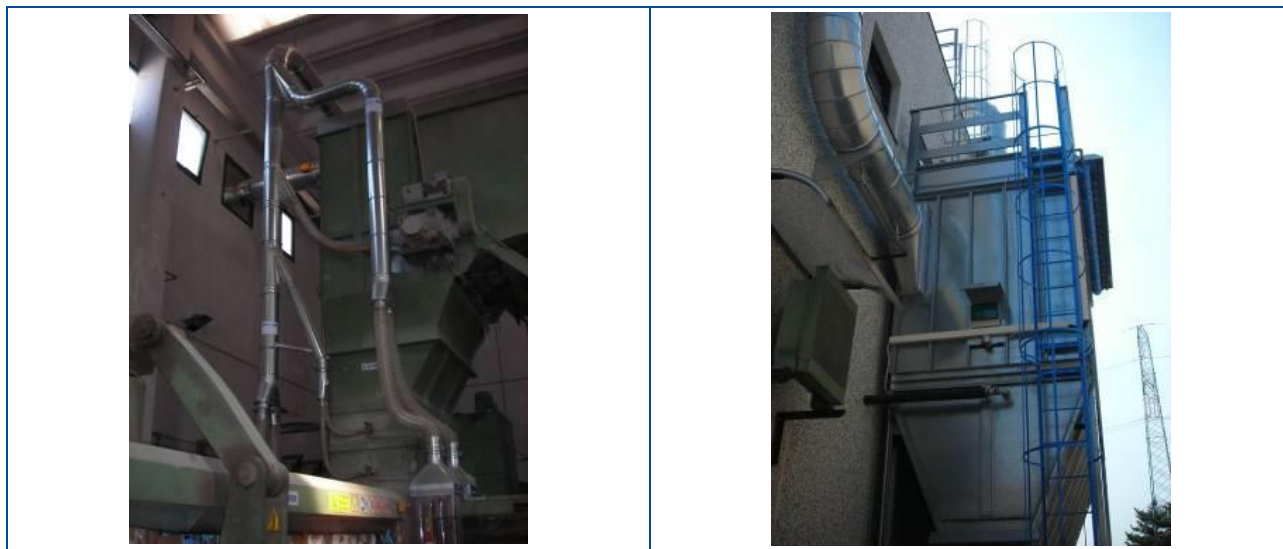
Figura 6.2 Impianto di abbattimento ed aspirazioni polveri
